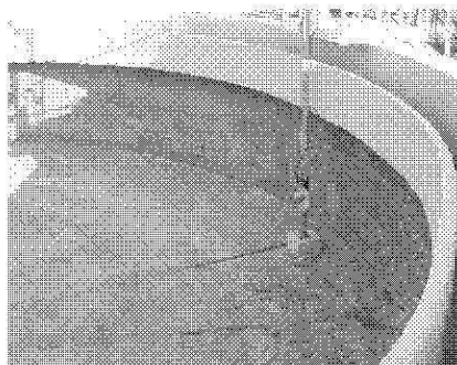
Рис. 3. Анаэробный резервуар с мешалками (бывший первичный отстойник) Fig. 3. The anaerobic tank with mixers (a former preliminary sedimentation tank)
