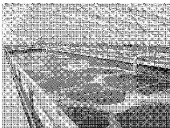
Рис. 6. Крытые сооружения аэротенков в г. Адлер Fig. 6. Covered constructions of aerotanks in Adler
